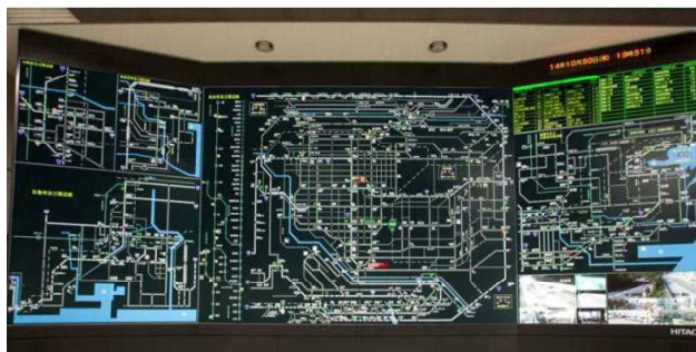
【交通管制センター】
